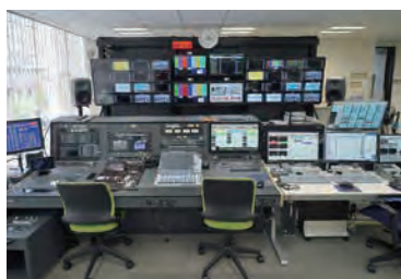
株式会社瀬戸内海放送様 岡山本社 報道サブシステム
